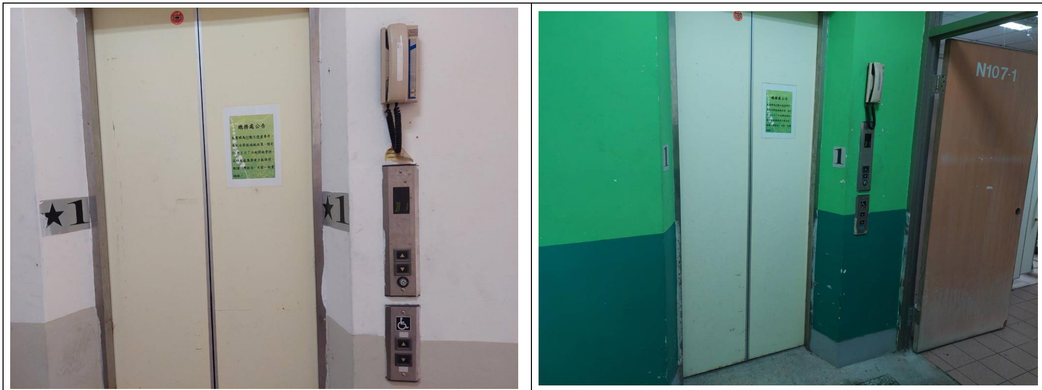
學校於工學館、管理館、商學館等大樓設置無障礙電梯。
